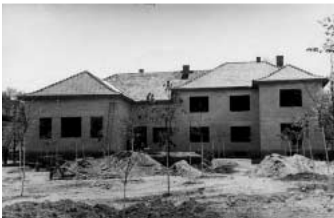
Die „Oppelcz-Villa“ im Rohbau, Sommer 1944, vor der Plünderung durch die Soldaten der Roten Armee
